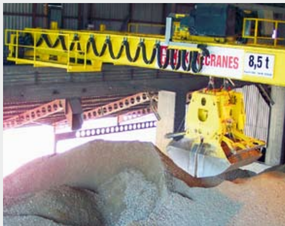
Automatisierter Prozesskran im Rohstofflager eines Zementwerkes
