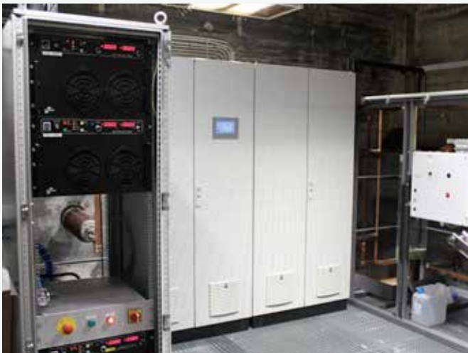
Schaltschrank der Steuerung
