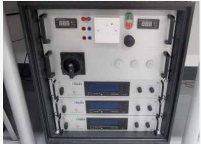
Prüfrack zur Steuerung der elektrischen Leistung und Überwachung der Prüfräume
