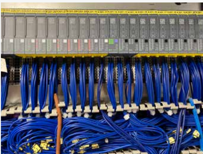
Steuerung (SIMATIC) im Detail
