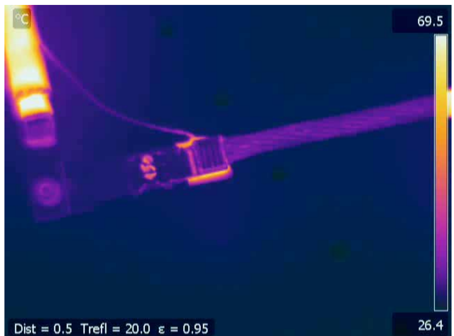
Wärmebild einer Kontaktstelle
